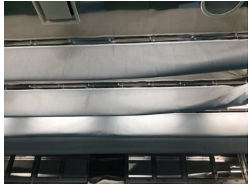
ソックダクト
